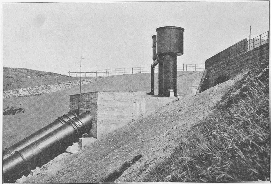
Abb. 26. Fixpunkt I mit den Standrohren der beiden Rohrstränge.
