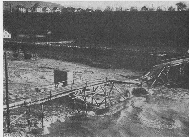
Abb. 14. Ueberschwemmung der Baustelle am 9. Dezember 1907.
