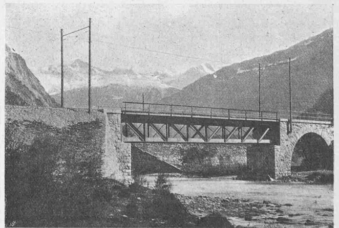
Abb. 6. Kontaktleitung auf der Drance-Brücke.
