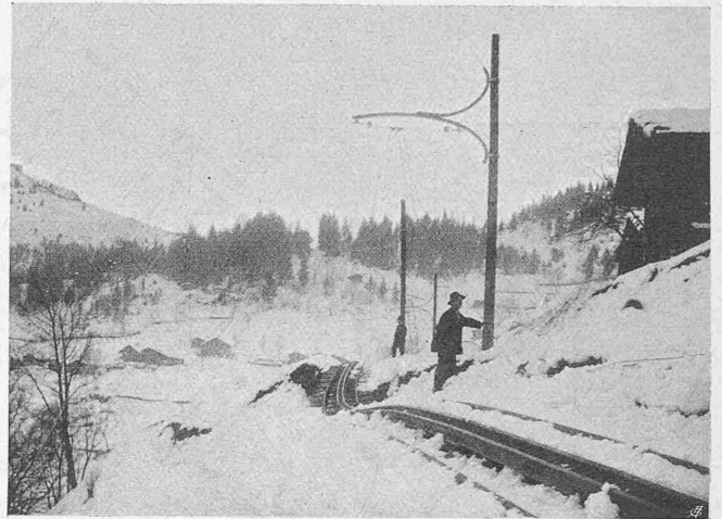
Abb. 27. Senkung des Bahnkörpers bei Km. 3,0.
