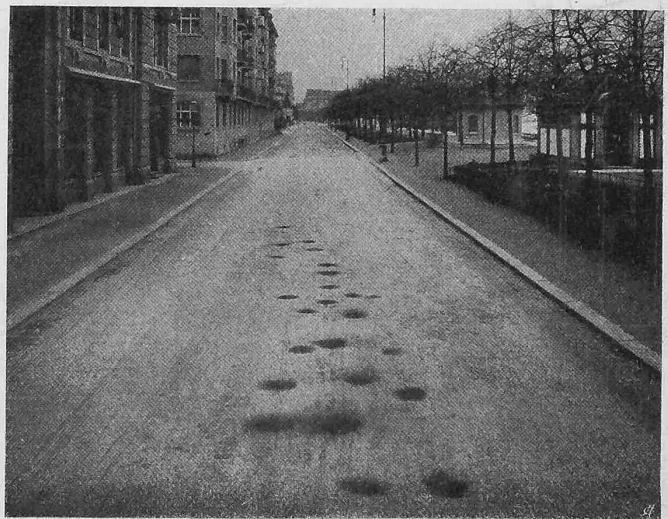
Abb. 2. Beschädigte Strassendecke aus Grauwackenschotter.
