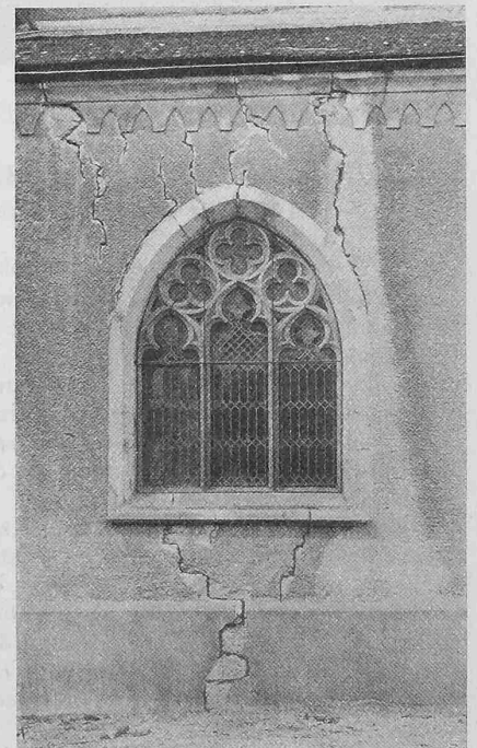
Abb. 19. Südl. Kapellenfenster mit Rissen.
