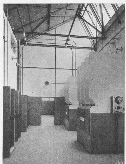
Abb. 11. Schalter der abgehenden Linien.
