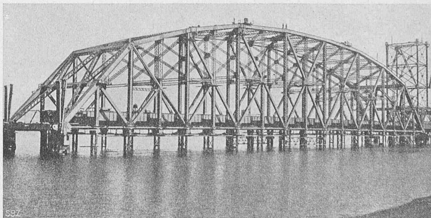
Einhängender Mittelträger der Quebec-Brücke, auf dem Montagegerüst (Nach „Eng. News“ v. 24. Aug. 1916).
