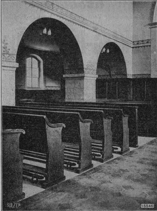
KIRCHE IN OBERWINTERTHUR ELEKTRISCHE NIEDERDRUCK-DAMPFHEIZUNG MIT UNTER DEN FUSSCHEMELN VERLEGTE HEIZRÖHREN.
