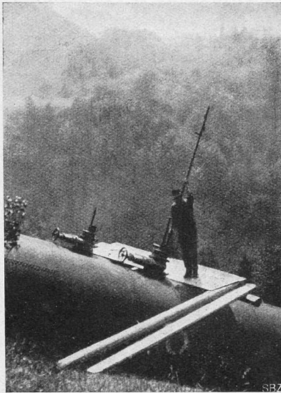
Abb. 3. Messtation für Flügel-Wassermessungen entspr. Abb. 2 auf zwei nebeneinanderliegenden Druckrohrleitungen von je 1801 mm Lichtweite.
