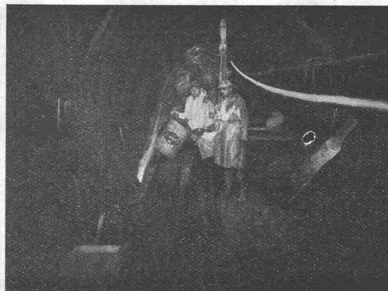
Sulgenbachstollen in Bern; Abdichtung starker Wassereinbrüche mit schnellbindender „SIKA“.
