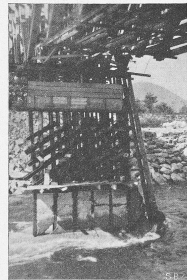
Abb. 1. Die planwidrige Pendelstütze, kurz vor dem Einsturz, den statt der vorgesehenen Ausbetonierung nachträglich aufgeklebte (!) Diagonalen noch hätten aufhalten sollen.
