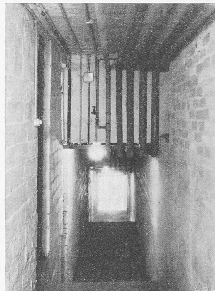
Abb. 53. Leitungsgang eines abgetrepten Häuserblocks.
