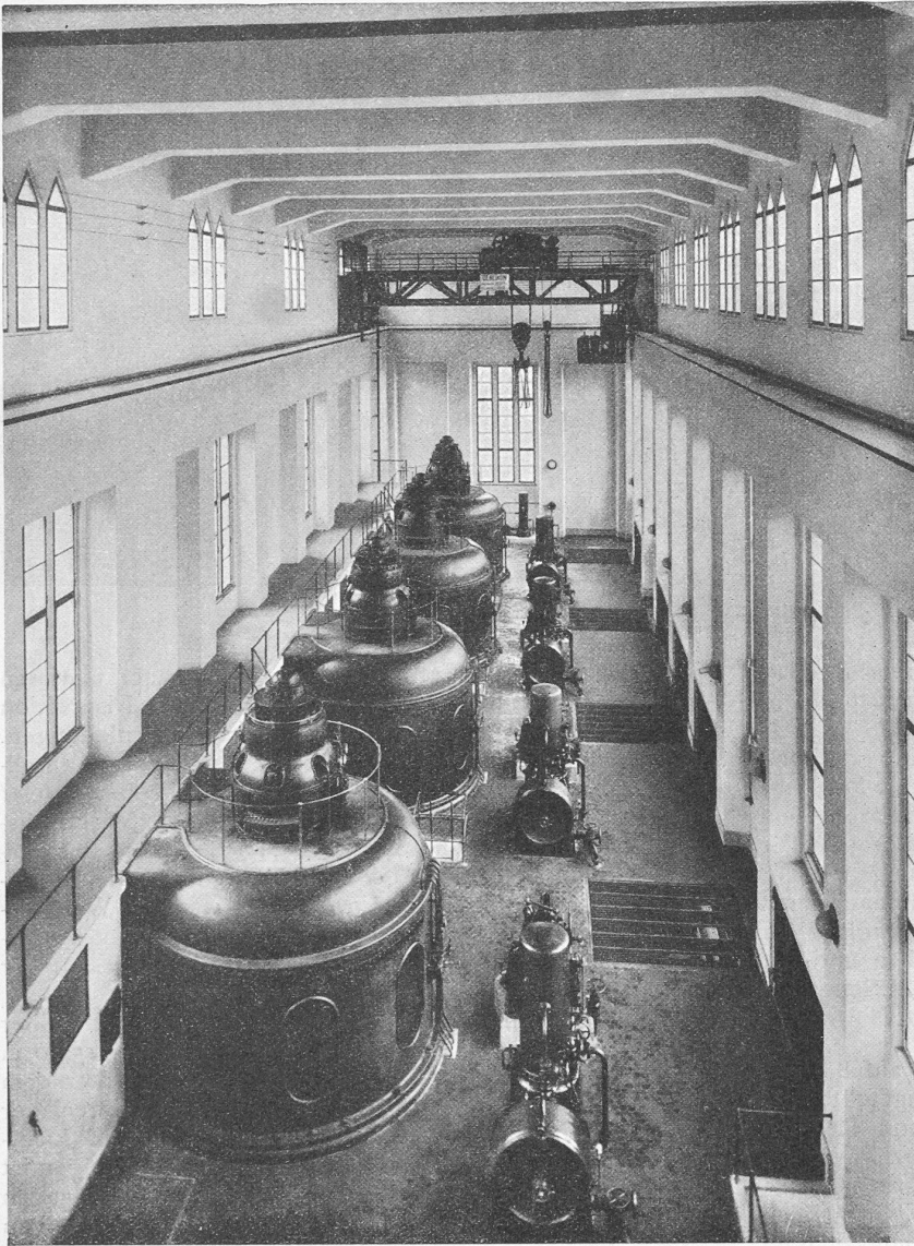
Abb. 68. Maschinensaal der Zentrale Siebnen.
