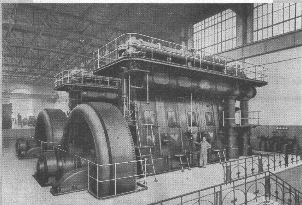
Die Abbildung zeigt die mit zwei Sulzer-Dieselmotoren von je 3000 PSe ausgerüstete Zentrale Coulouvrenière der Stadt Genf
