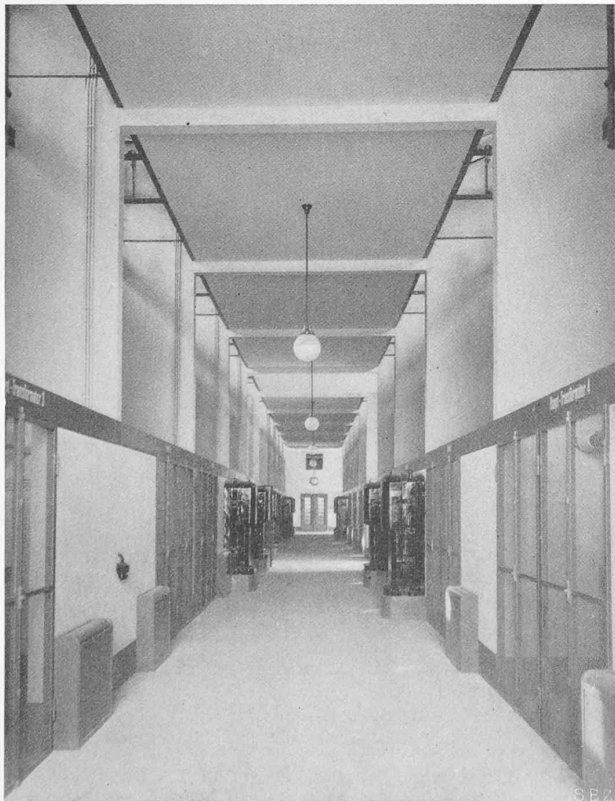
Abb. 47. Bedienungsgang der 10,5 kV-Hauptschaltanlage.
