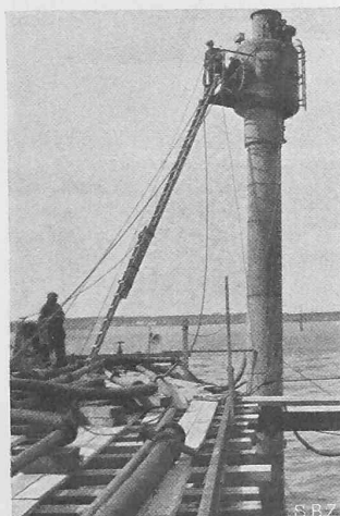
Abb. 11 Absenkung des westlichen,
