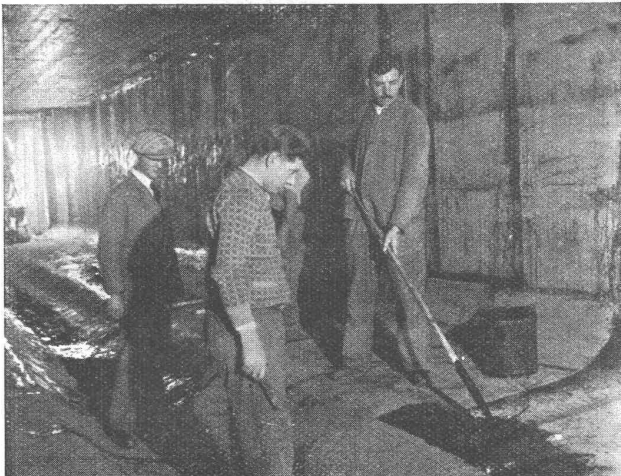
Interessante Isolierung eines Sole-Behälters
