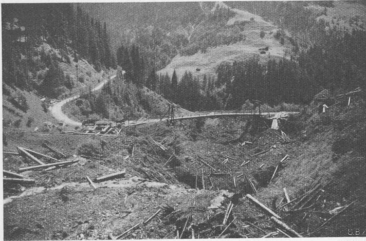
Abb. 16. Hängebrücke in Holzbau, erbaut von Prader & Co. (Chur), als Hilfsbrücke anstelle der zerstörten eisernen im Safiertal
