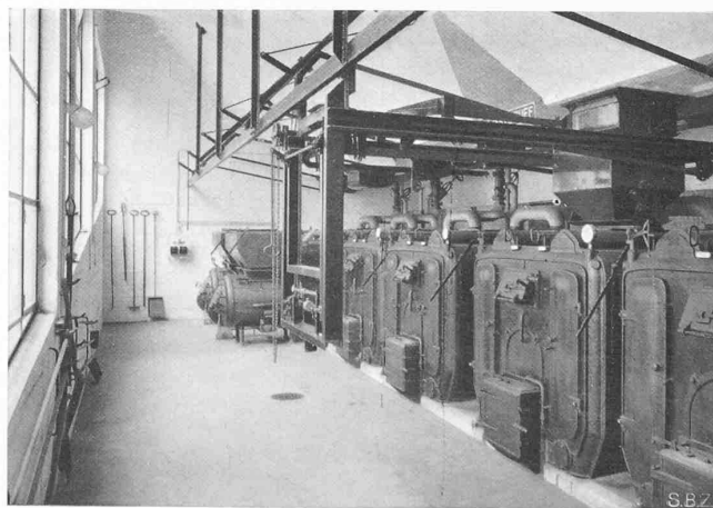
Abb. 20. Heizung mit Beschickungs-Laufkran verbunden mit Waage
