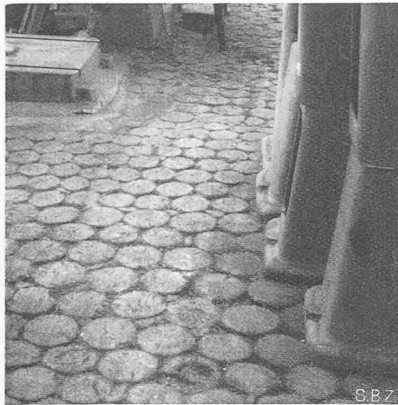
Abb. 1. Alter Holzpflasterboden aus Rundlingen
