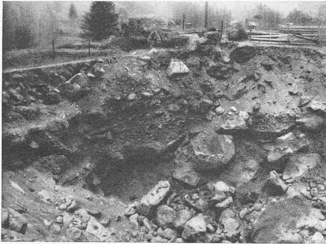
Abb. 1. Tagbruch-Trichter über dem Umlauf-Tunnel
