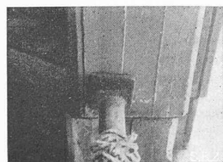
Bild 2. Randbalken, \frac{1}{3} der Verschiebung bereits behoben
