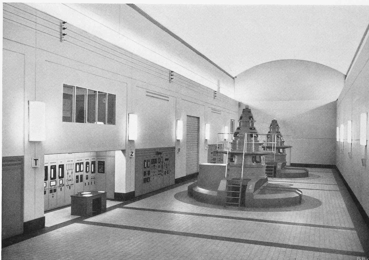
Zentrale Handeck II, Maschinensaal
