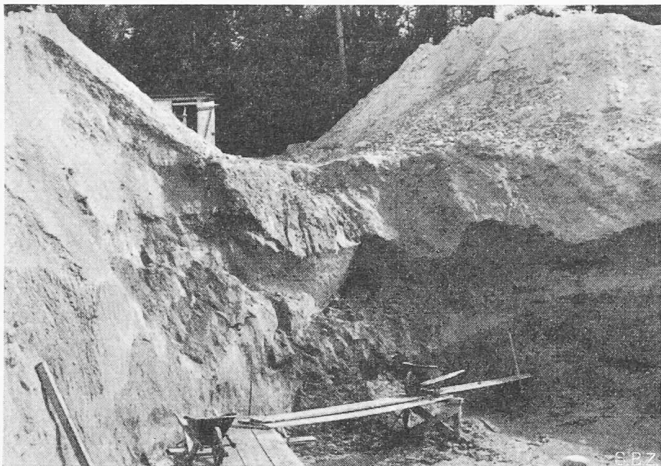
Bild 3. Die ganze Baugrube im feinen lehmigen Sand ist ausgehoben; nun beginnen die Wände auszubrechen, und es sollten, ohne jede sichernde Spriessung oder genügend abgeflachte Böschungen, die Fundamente und Aussenwände erstellt werden.
