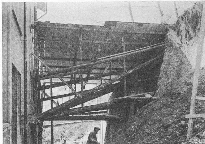
Bild 4. In einer Rippe aus Moränematerial werden vorerst die Baugrube ausgehoben und der Hochbau erstellt; dann soll die bergseitige Stützmauer ausgeführt werden; der Anschnitt beginnt zu rutschen und zu fließen. Nun ist für den Bau der Stützmauer eine schwere und komplizierte Spriessung zur Fassade und von dort, im Innern des Hauses, bis zu den Fundamenten des Hochbaues notwendig.
