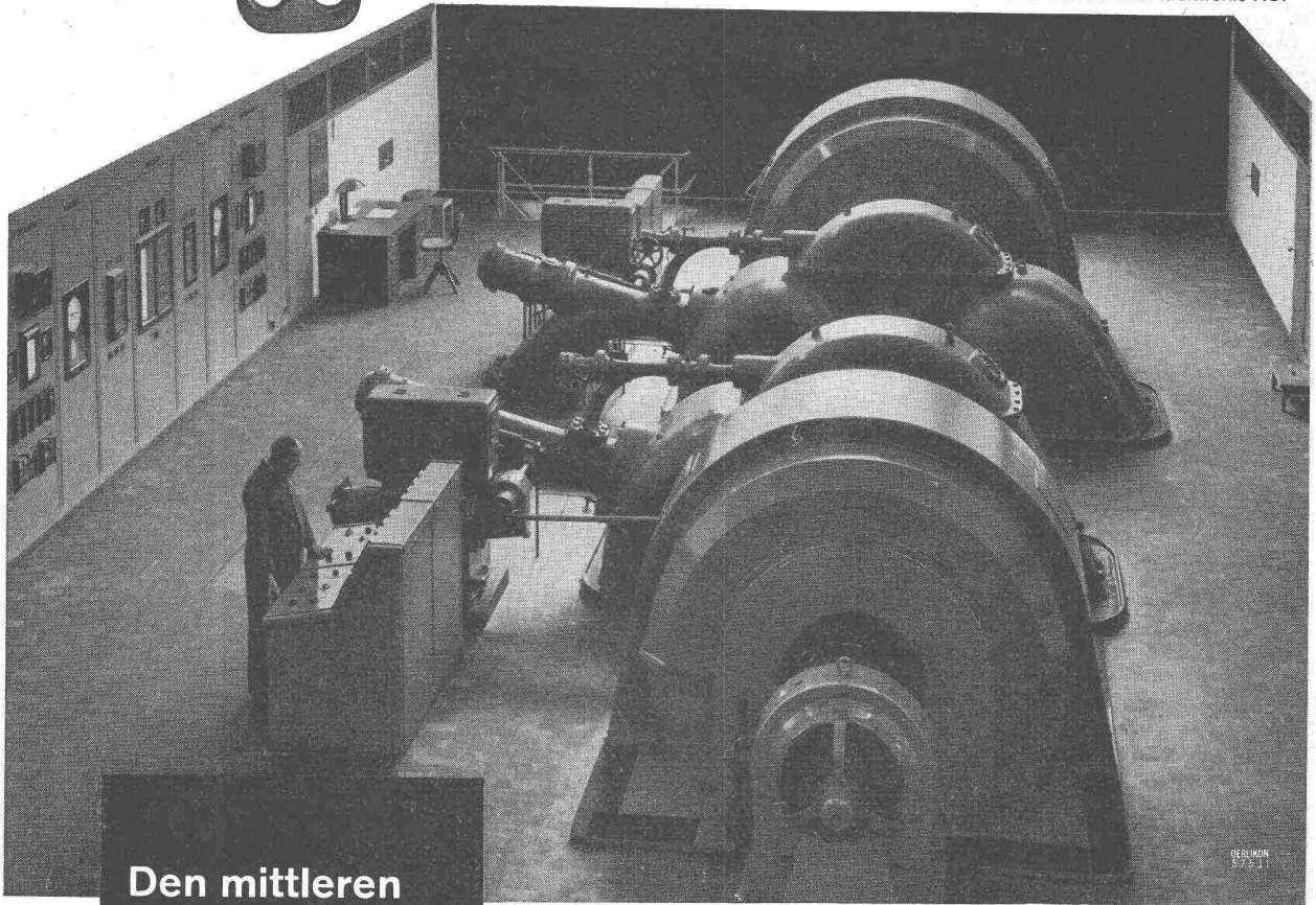
Zentrale Fätschbach der Nordostschweizerischen Kraftwerke AG.
