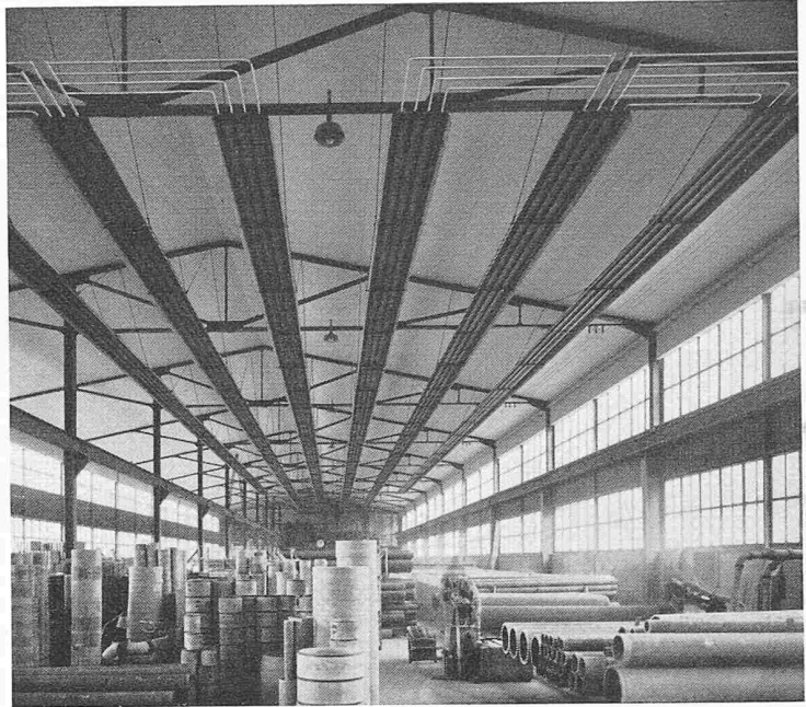
Bild 5. Bandstrahler in der neuen Röhrenfabrik der Eternit AG, Niederurnen
