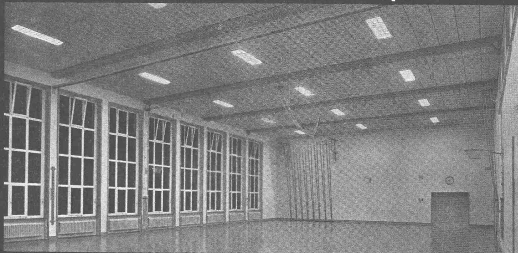
Ein Beispiel einer Turnhallenbeleuchtung
