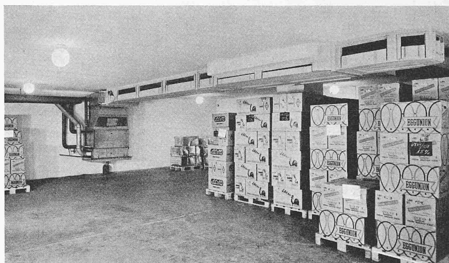
Bild 4. Blick in einen Eierlagerraum mit Kaltluftkanal an der Decke und Luftkühler an der Rückwand. Die Frischluft-Zufuhrleitung tritt von links unten in das Luftkühlergehäuse ein
