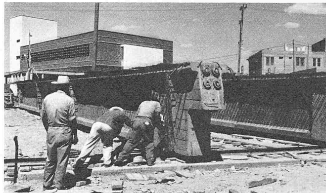
Bild 8a. Querverschieben zum Gleis mit Rätchenflaschenzügen. Als Unterlage für die Gleitschiene und zur Aufnahme des Auflagerdruckes nach dem Vorspannen ist an den Trägern ein Fundamentstreifen aus Beton hergerichtet worden. Die Schalung ruhte dazwischen nur auf einem Holzschwellenrost, mit dem auch die Bodenunebenheiten ausgeglichen wurden
