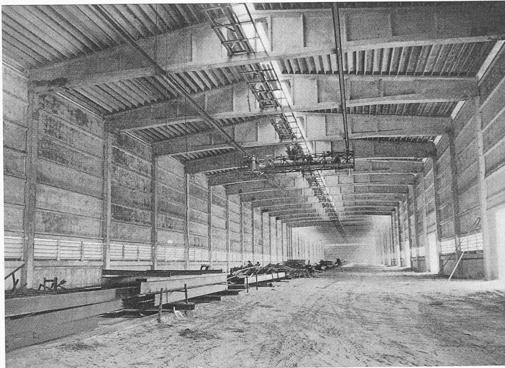
Bild 6. Vollständig vorfabriziertes Industriegebäude. Die sehr verbreiteten T-Träger bilden die Dach-elemente. Photo Modern Concrete Magazine, Chicago, Illinois
