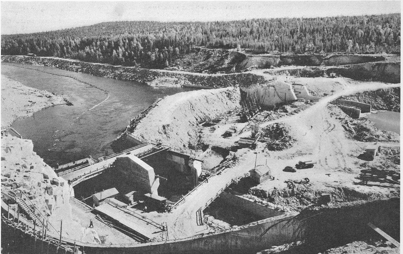
Bild 3. Uebersicht über die Baustelle. Vorn links die Flossrinne, dann nach rechts anschliessend die Wehröffnung I, dann der im Bau befindliche Erddamm, ganz hinten die Wehröffnung II
