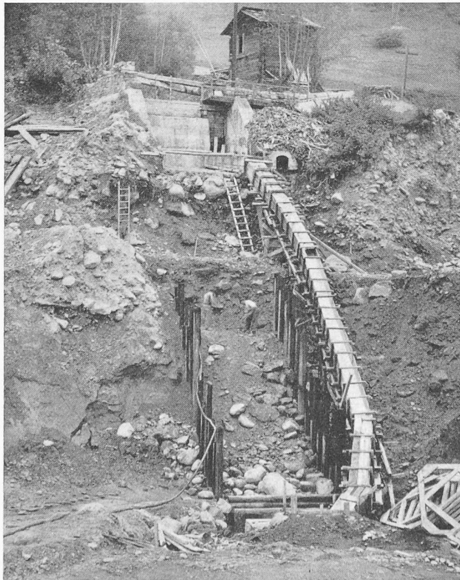
Bild 10. Aushub für den Torrent-du-Moulin-Durchlass; Grabenspriessung mittels eisernen Spundwänden, alte Wasserfassung mit Bachumleitung
