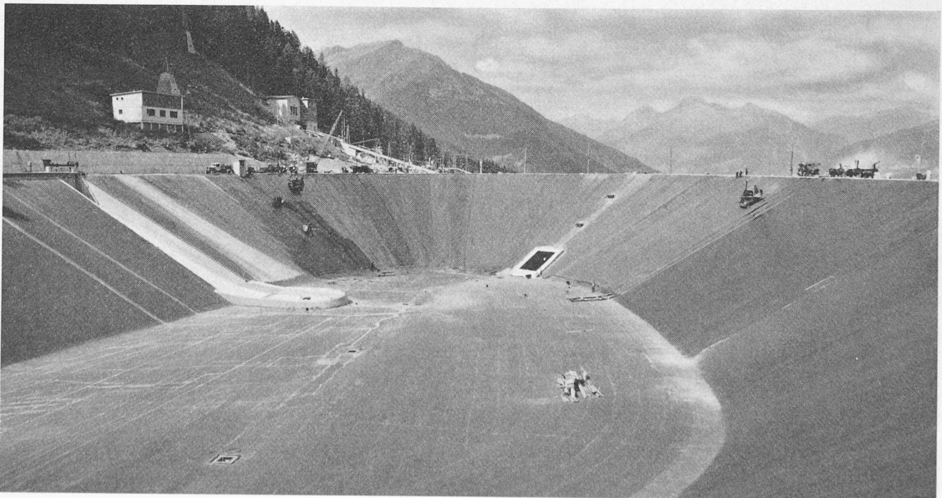
Bild 4. Ausgleichbecken Rosswiese der Oesterreichischen Draukraftwerke
