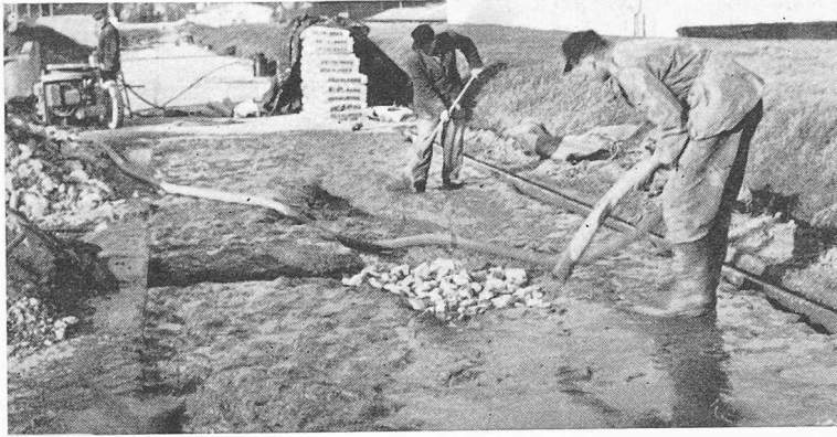
Bild 4. Instandsetzen einer Prüfstrasse für schwere Kettenfahrzeuge: nach dem Aufstemmen der Risse bis aufs Planum und Säubern der Ränder mit Druckluft und Wasser werden diese Flächen mit Colgrout angespritzt, mit Schotter ausgefüllt und mit Colgrout übergossen. Für die Verschleisschicht wird anschliessend in die noch nicht abgebundene Colgrout-Oberfläche Hartsteinsplitt eingestreut
