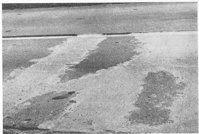
Bild 7. Platte von Bild 6 nach der Instandsetzung: Anspritzen der alten Betonflächen mit Colgrout, Schliessen der Risse mit Rollkies 15/30 mm \varnothing und Colcrete-Spritzbeton lagenweise eingebracht und Einstreuen von Splitt in die Oberfläche für die Verschleisschicht (Ansicht nach Benutzung durch den Verkehr)
