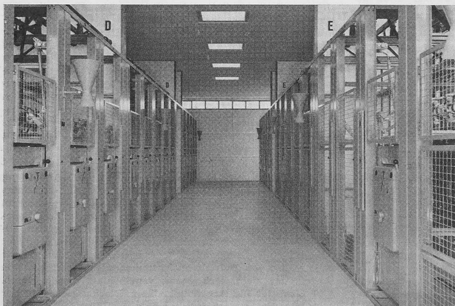
Bild 6. 10 kV-Betriebsenergieverteilanlage im Unterwerk II
