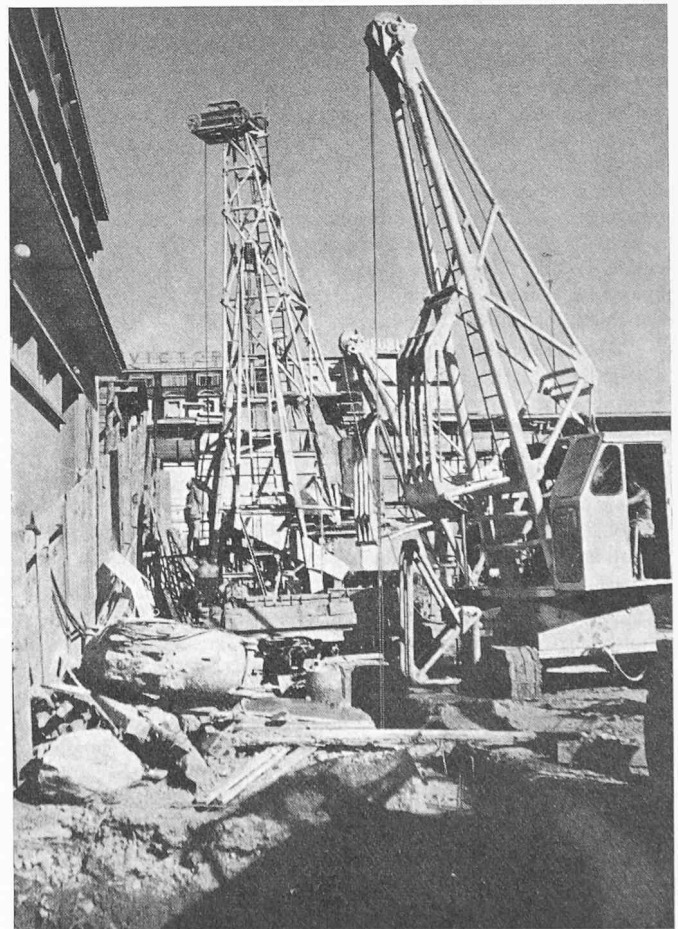
Bild 10. Hotel Continental, Lausanne. Bohr- und Aushubmaschinen bei der Arbeit längs des Fahrweges. Blick nach Osten
