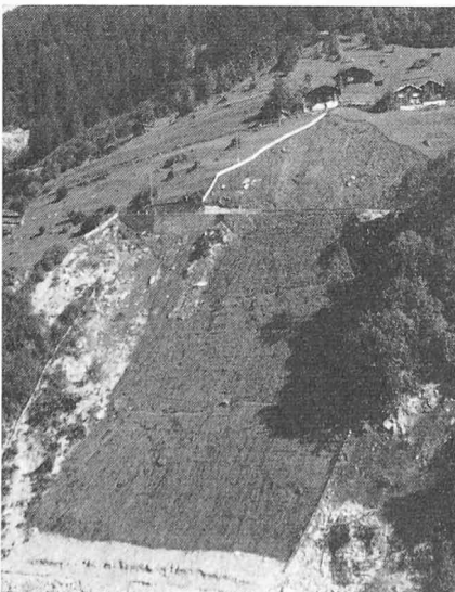
Bild 3. Hangrutsch Caprau bei Disentis nach Sanierung durch Saat auf Stroheckschicht
