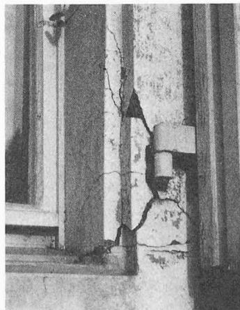
Bild 1. «Klassischer» Baufehler: Fensterladen-Kloben wurden mit einem Baugips-Portlandzement-Gemisch rd. 1:1 in Kunststein eingegossen. Nach etwa zwei Jahren wurde der Kunststein wie von einer Sprengladung auseinandergerissen und muss wie alle übrigen an der Wetterseite dieses Neubaus ersetzt werden
