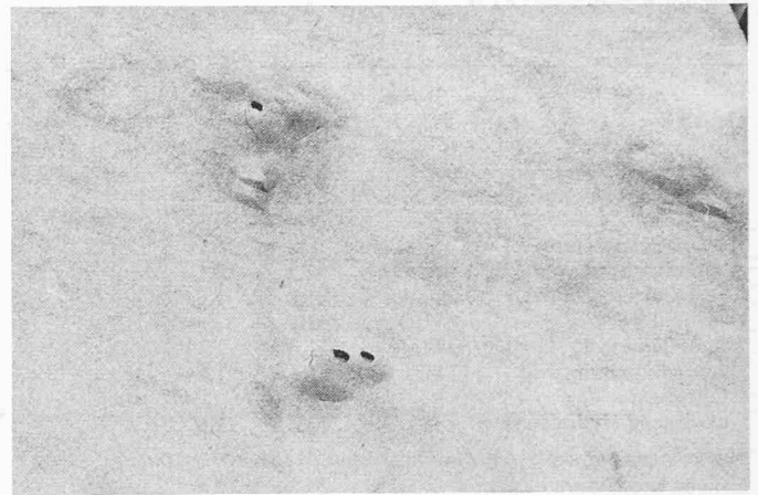
Bild 8. Blasenbildung an der Fassade eines neuen Miethauses im Tessin, an welcher der Deckputz mit ungenügend gelöschtem, dolomitischem «Weisskalk» hergestellt wurde. Die Blasen entstanden etwa drei Jahre nach dem Verputzen, sie vermehren und vergrössern sich zusehends. Der ganze Putz muss erneuert werden, diesmal hoffentlich mit normengerechtem, echtem Weisskalk
