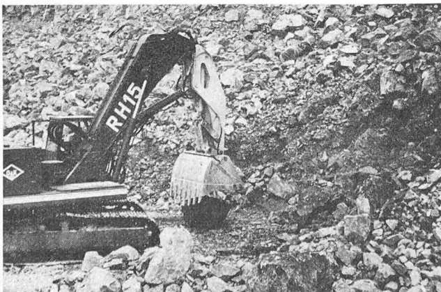
Bild 10. Aufnahmen und Beiseiteschieben grosser Steine aus dem Grabbereich. Das Bild zeigt eine typische Schaufelstellung, wie sie nur bei Hydraulik-Baggenern möglich ist
