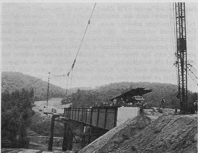
Bild 1. Ansicht der Baustelle während des Ausrichtens eines Brückenträgers mittels Seilbahn und neigbaren Türmen
