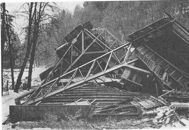
Bild 1. Das alte Tribürendach nach dem Einsturz
