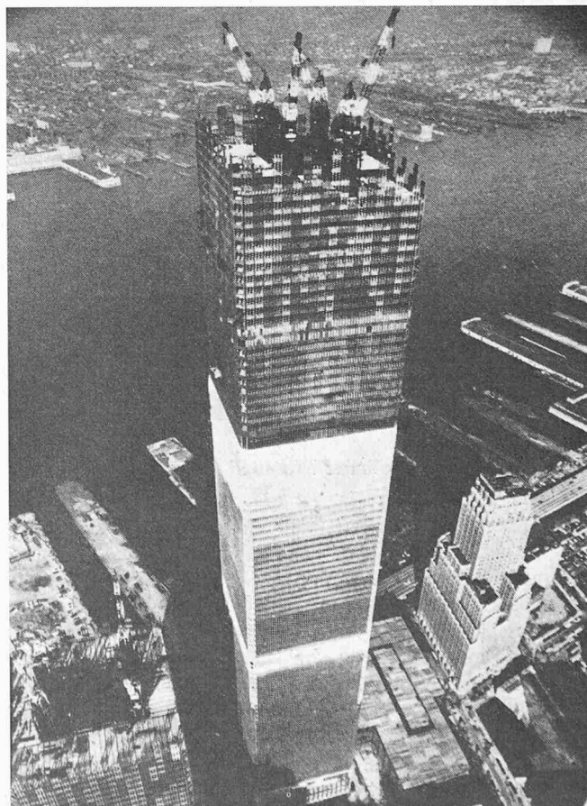
Bild 4. Auf dem Büroturm sind die vier Krane gut zu erkennen. Bauzustand etwa Mitte 1971
