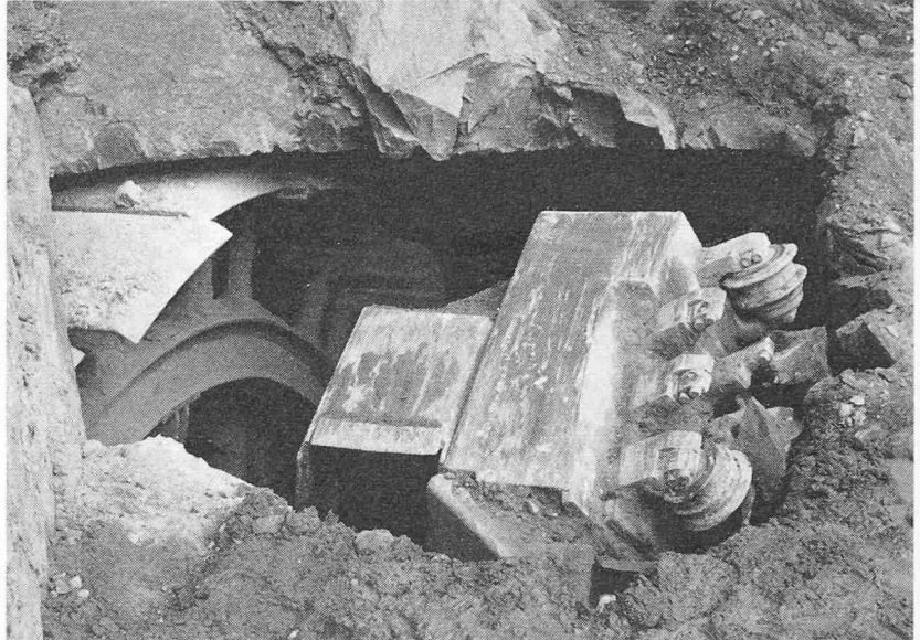
Bild 4. Durchbruch der Wirth TBE IV auf der Nordseite. Das Maschinenchassis befindet sich rechts vom Bohrkopf, welchem der schreitende Einbau unmittelbar folgt
