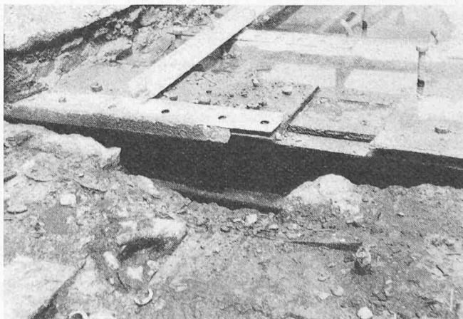
Bild 3. Stark verrostete Konstruktion eines Fahrbahnüberganges
