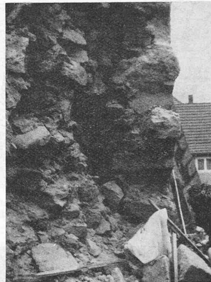
Bild 8 (rechts). Der Querschnitt der talseitigen Längswand des Ostraktes der Burg. Blickrichtung A gemäss Bild 6, unten. Die dunkle Stelle oben in Bildmitte ist ein Loch mit etwa 20 \times 80 cm Querschnitt, das fast 2 m tief in die Mauer hineinragt
