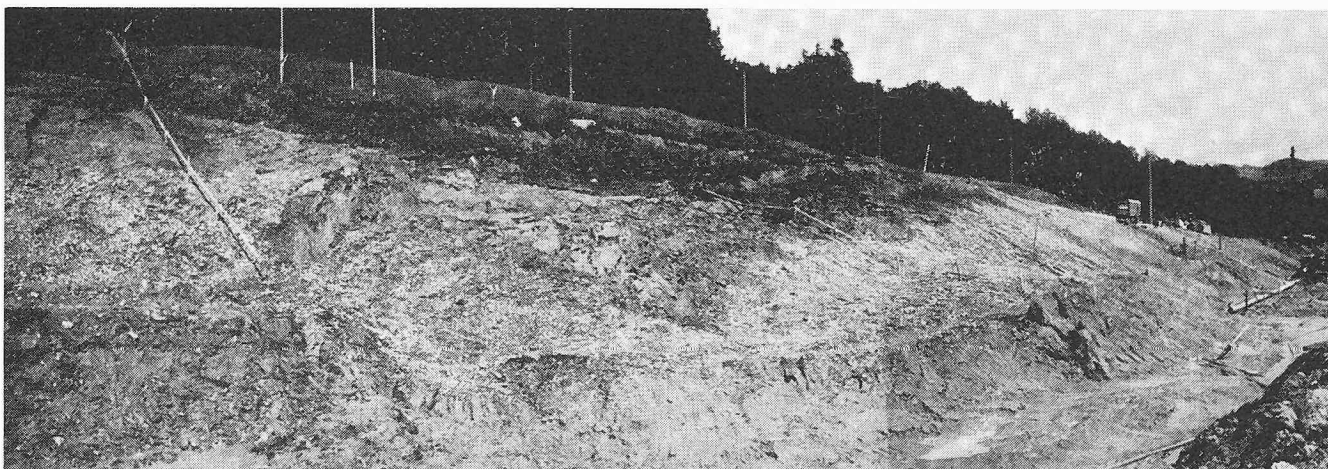
Bild 11b. Böschungsrutschung nach einer Woche
