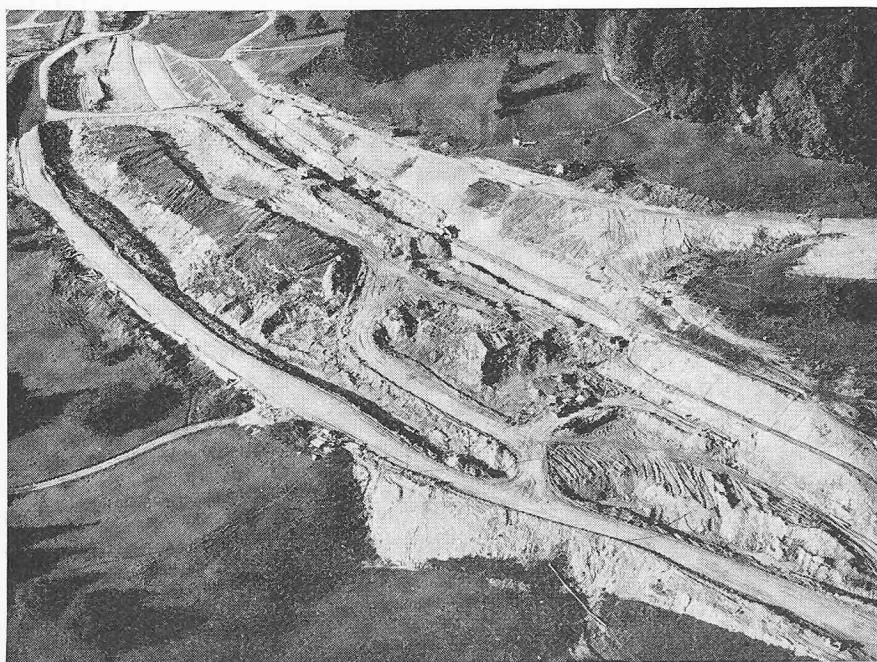
Bild 14. Flugaufnahme der Baustelle. Oben links ist der Abschnitt im unverrutschten Gebiet sichtbar, bei welchem die Arbeiten ohne Schwierigkeiten gemäss Projekt ausgeführt werden konnten. Der Aushub ist dort beinahe vollendet. In Bildmitte ist der Aushub nur bis zur ersten Berme vorgenommen. Die helle Zone zwischen der Berme und dem Flurweg am oberen Rand des Einschnittes zeigt die provisorisch sanierten ersten Rutsche
