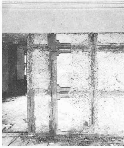
Freigelegte Riegelbemalung aus der Entstehungszeit
