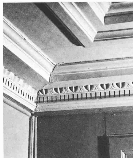
Ausschnitt aus der Kassettendecke vor der Restaurierung
