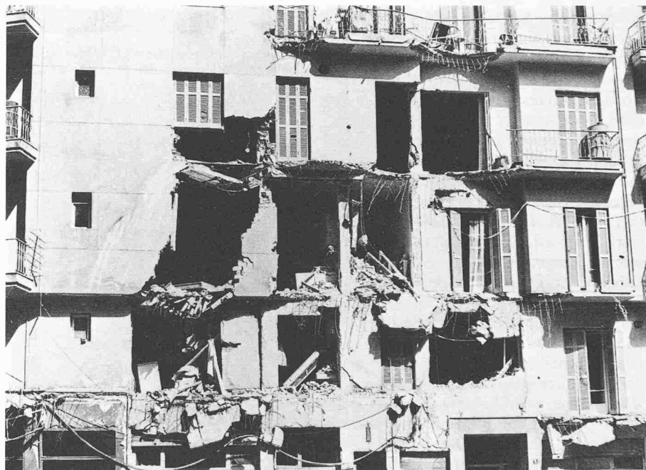
Fassadenschäden, verursacht durch den Einsturz des gegenüberliegenden 9stöckigen Gebäudes. Sekundäre Schäden infolge zu geringem Gebäudeabstand
