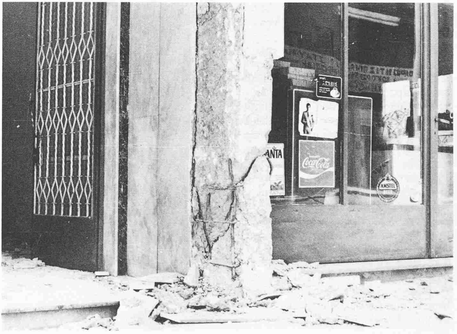
Geknickte Stützen der Tragkonstruktion, etwa 50 cm über dem Erdboden
